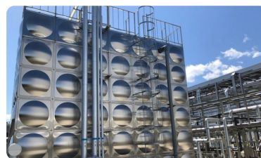
那須工場の水処理施設
