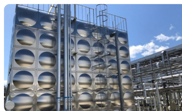
那須工場の水処理施設
