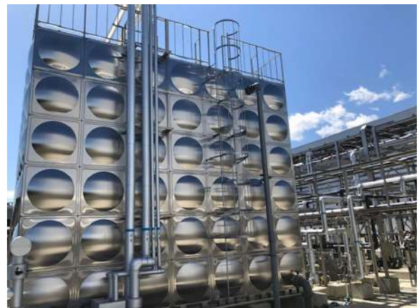
那須工場の水処理施設
