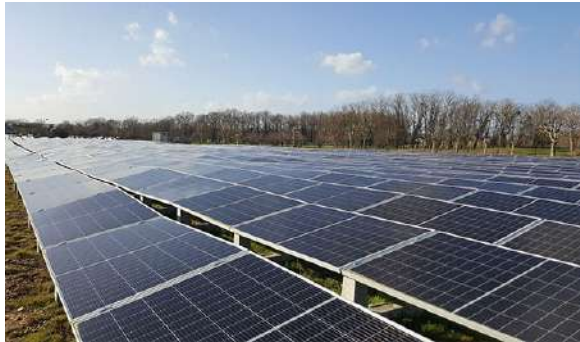
ジアン工場のソーラーパネル（フランス）
