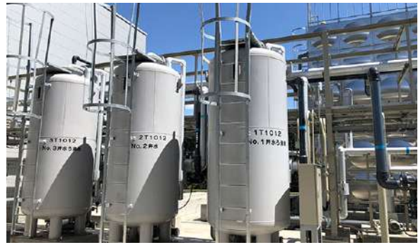
同工場、地下水の浄化システム
