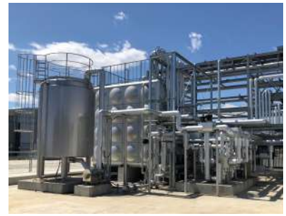
那須工場の自動洗浄装置（日本）
