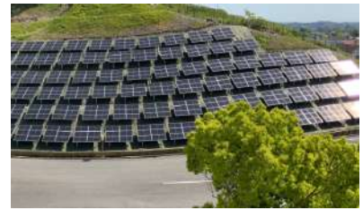
掛川工場のソーラーパネル（日本）
