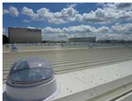
太陽光照明（屋上）
