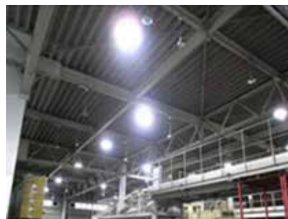
太陽光照明（倉庫内）
