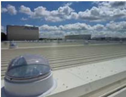
太陽光照明（屋上）
