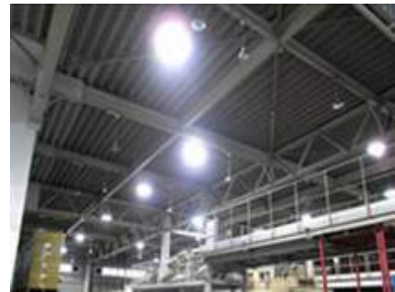
太陽光照明（倉庫内）
