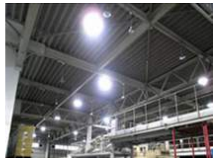
太陽光照明（倉庫内）
