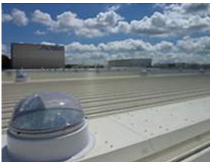
太陽光照明（屋上）
