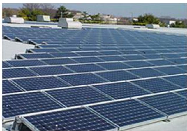
一次導入設備（角度固定式）
