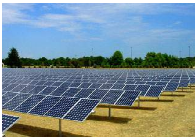
二次導入設備（太陽追尾式）
