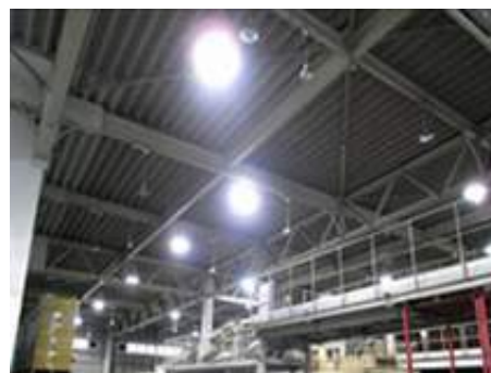
太陽光照明（倉庫内）
