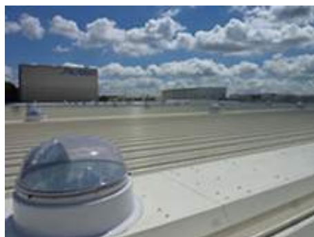
太陽光照明（屋上）
