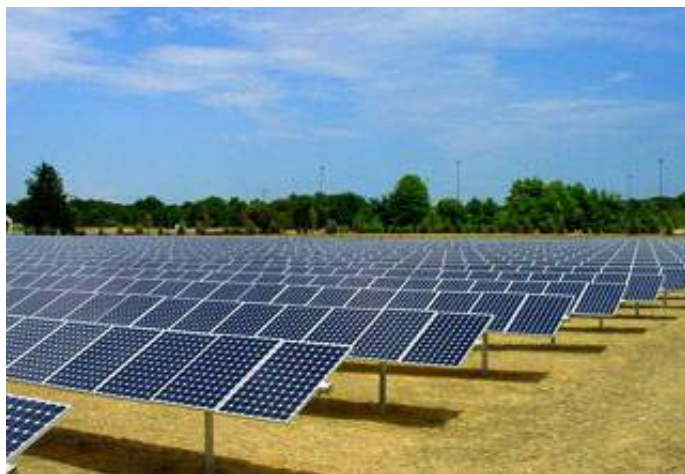
二次導入設備（太陽追尾式）
