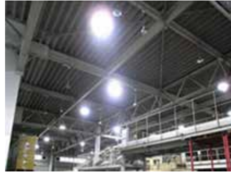
太陽光照明（倉庫内）
