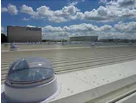
太陽光照明（屋上）
