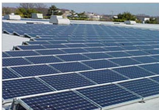
一次導入設備(角度固定式)
