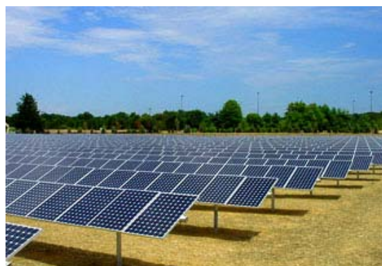
二次導入設備(太陽追尾式)
