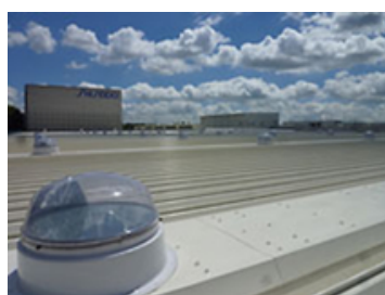
太陽光照明(屋上)
