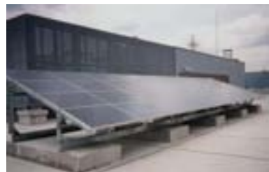
屋上のソーラーパネル
