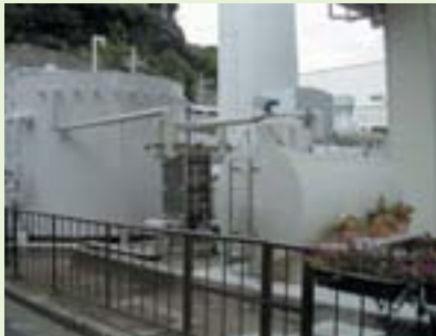
ボイラー廃熱回収装置
