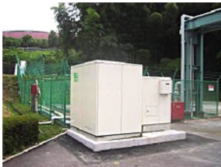
掛川工場: LPGから都市ガスへ燃料転換
